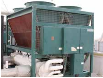
الشكل 1-2 أجهزة المبردات المركزية 4
